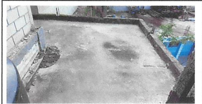
Foto 3: Impermeabilización de loza de la cocina por humedad y filtración de agua.
