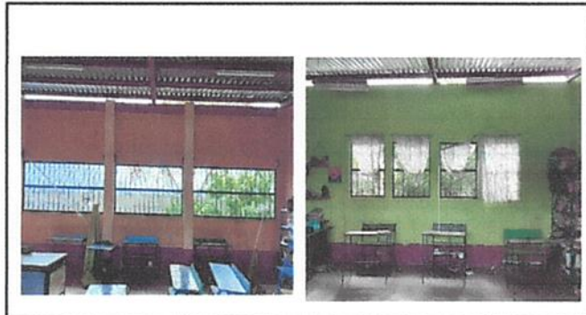
Foto 2: Se necesita colocar ventanas de la parte trasera de 4 aulas
