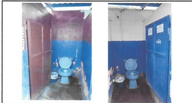
Foto1: Es necesario colocar azulejo en la pared, piso y sustitución de puertas de metal.
